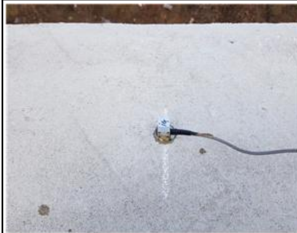
가속도계 설치 현황
