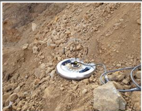
처짐계 설치 현황
